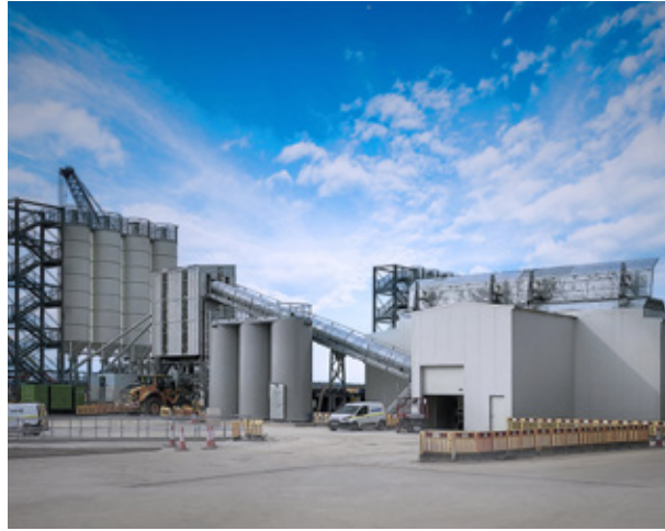
▲ HS2 Projesi Meka Beton Santrali / İngiltere
